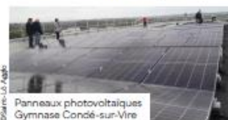
© Agglo de Numéris Panneaux photovoltaïques Gymnase Condé-sur-Vire
